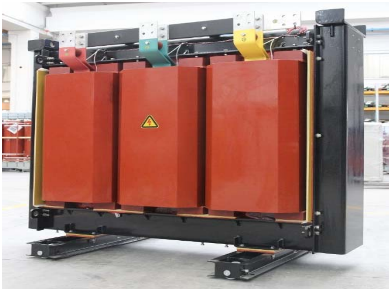
Giethars transformator met amorfe kern, LS zijde
